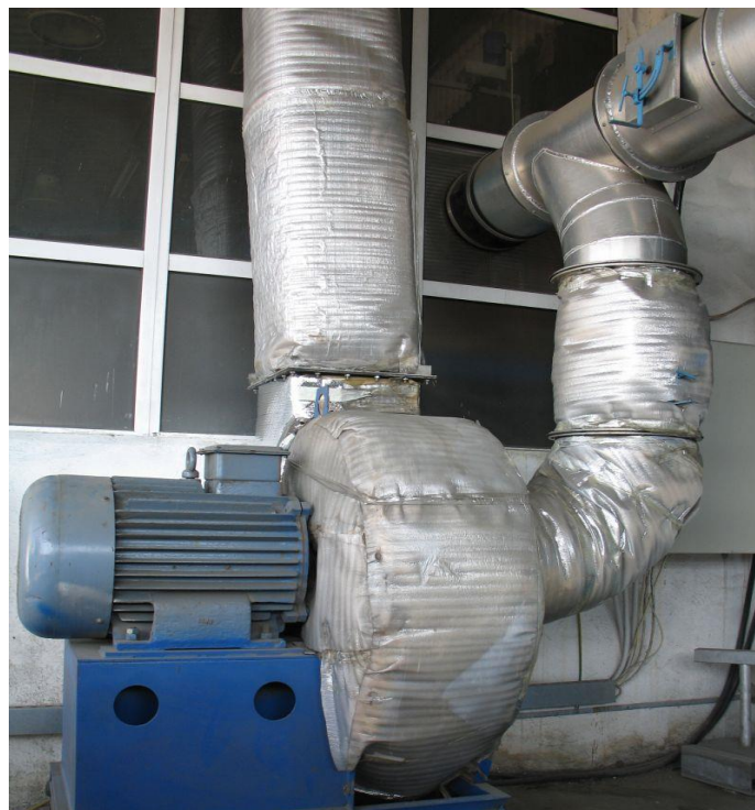
Fig.7.4. Ventilatorul de aer cu motor electric de 55kW
