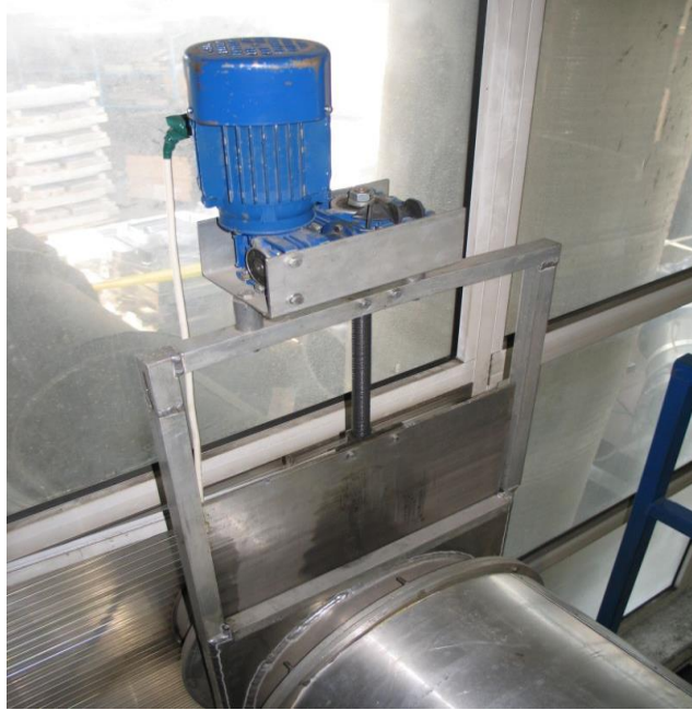
Fig.7.5. Motor-reductor pentru reglarea debitului de aer
