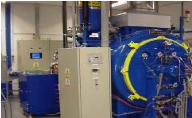
Fig.5.6. Instalație de brazare în vid
