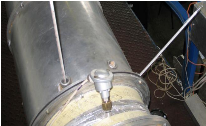
Fig.7.11. Dispunerea termometrelor și termorezistențelor pe canalul de aer
