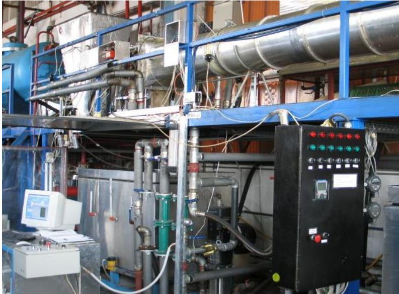
Fig.7.10. Panoul de comanda pentru pompele de apă și ulei
