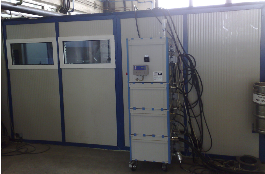
Fig. 2.18 Cabina izolatoare fonic a echipamentului de pulverizare termică
