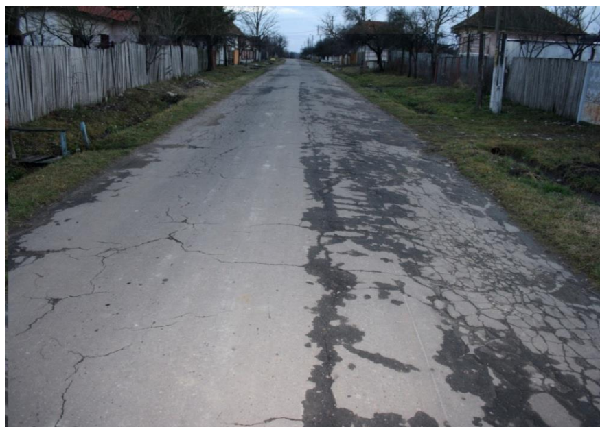
Fig.2.17. Tasări locale - DJ665C km 14+300
