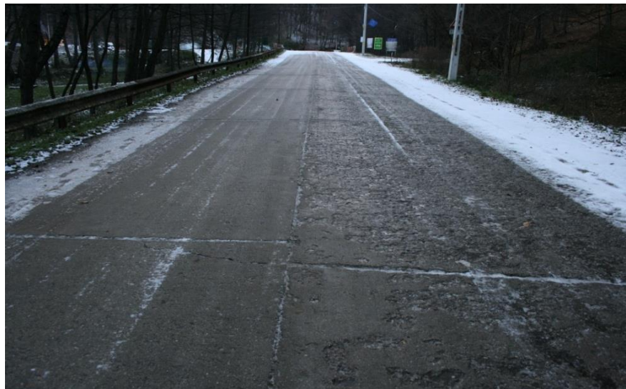
Fig.2.19. Suprafață exfoliată - DJ672A km 3+400
