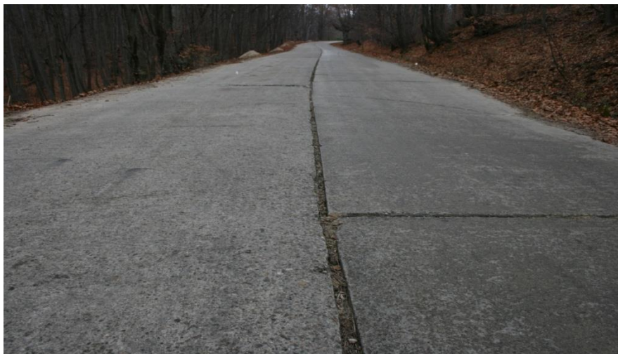
Fig.2.21. Deschiderea rosturilor longitudinale - DJ 664 km 4+450
