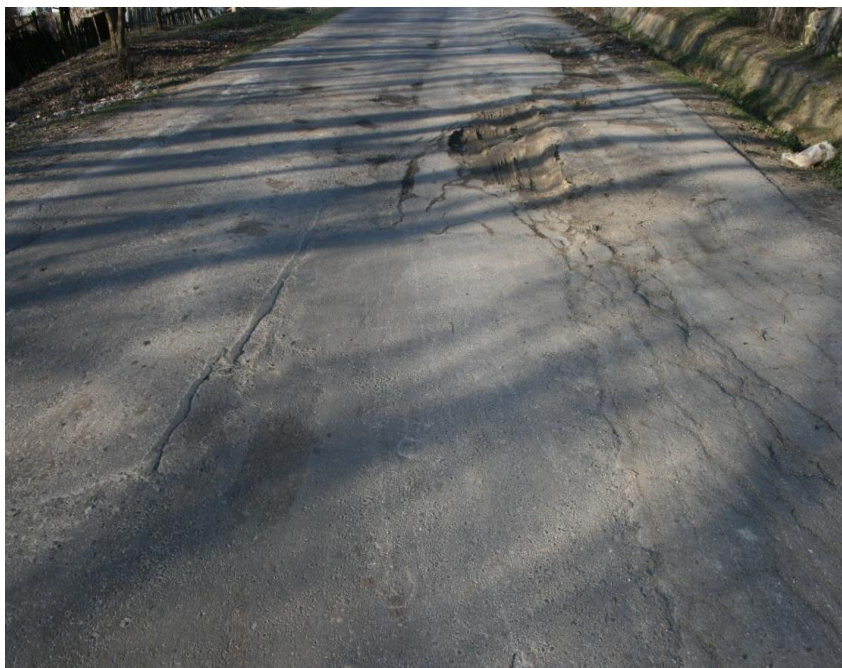
Fig. 2.6. Văluriri și refulări - DJ672 km 10+700
