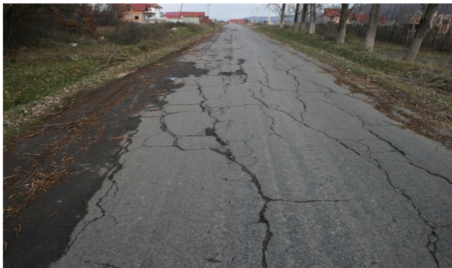
Fig.2.11. Fisuri pe diverse generatoare DJ 665A km 0+200
