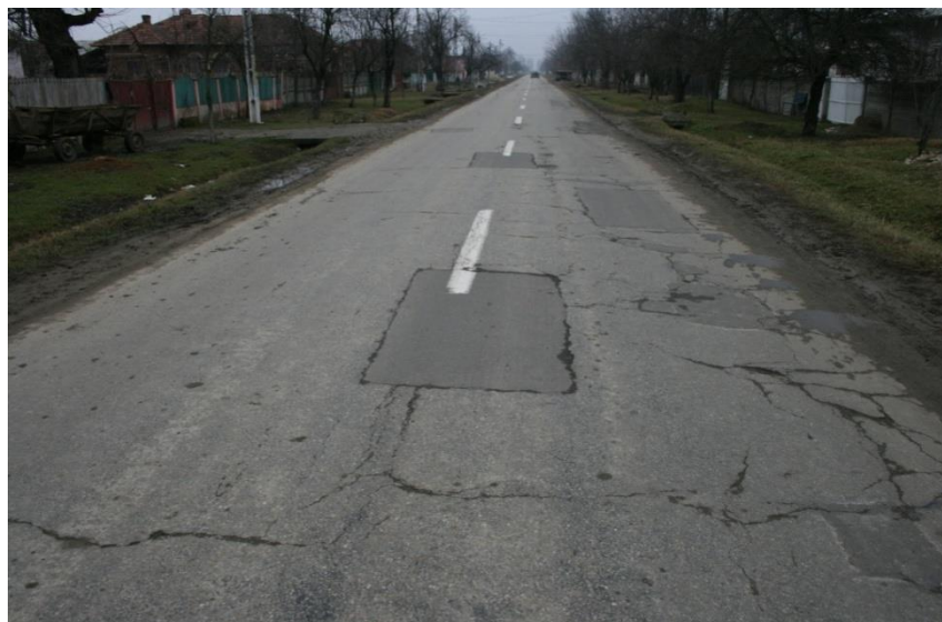
Fig.2.10. Fisuri și crăpături transversale - DJ 605 km 33+210
