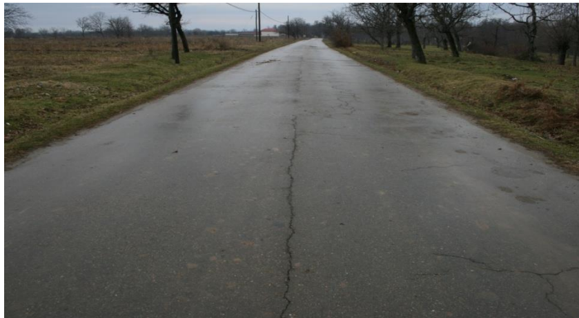
Fig.2.12. Fisuri si crăpături în axul drumului - DJ 664A km 9+900
