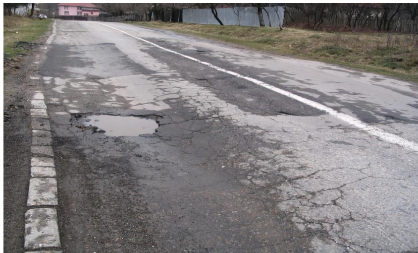
Fig.2.16. Degradări provocate de îngheț-dezghet - DJ665 km 11+350
