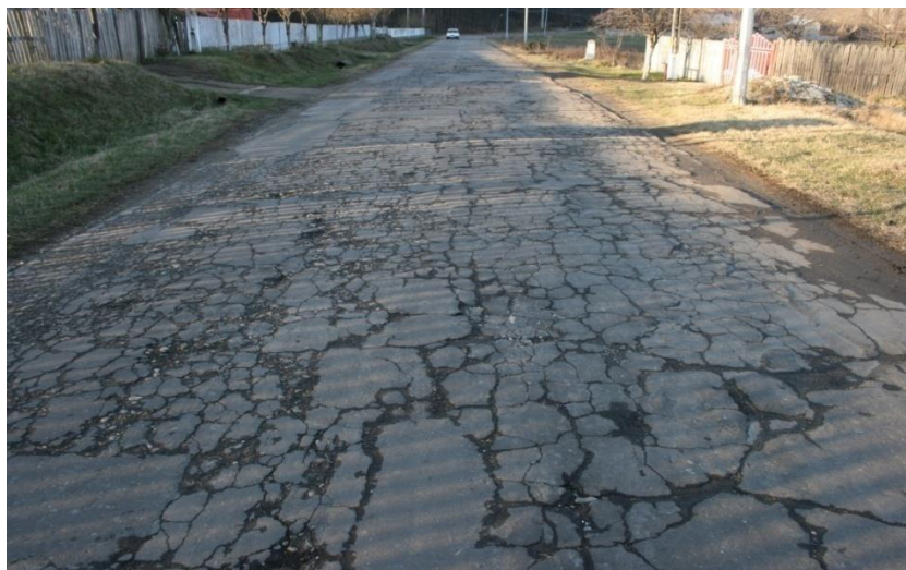
Fig. 2.13. Fisuri și crăpături multiple pe direcții diferite - DJ662 km 4+950
