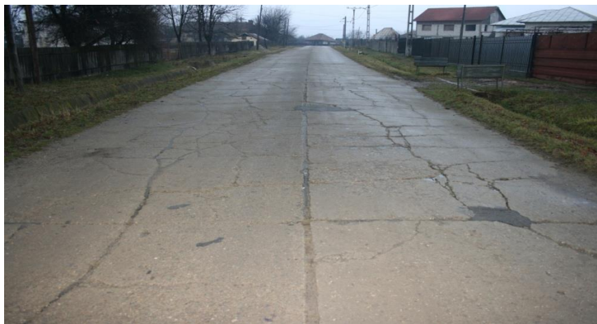
Fig.2.23. Fisuri și crăpături DJ 663 km21+370
