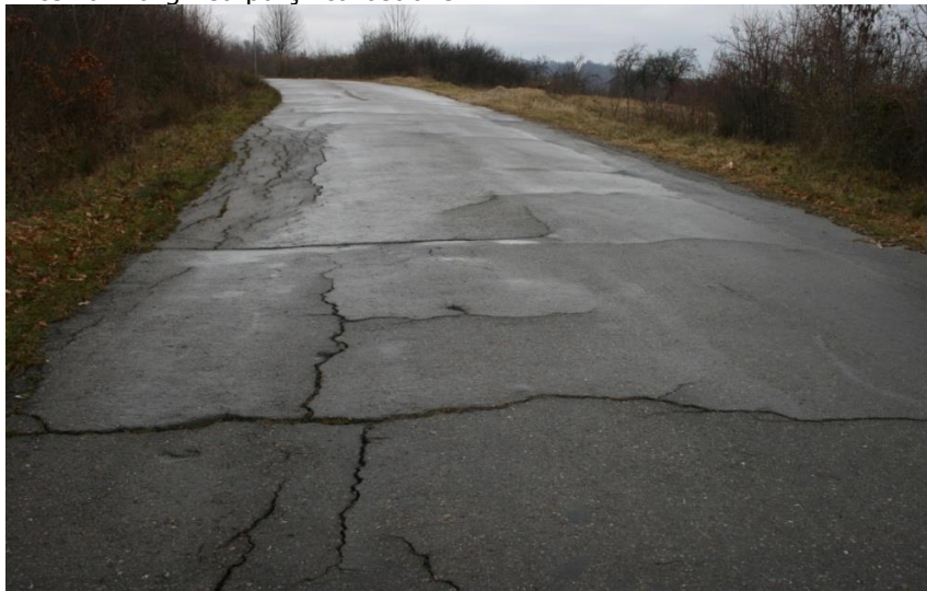
Fig.2.9. Rupturi de margine DJ 664A km 1+100 – foto 2
