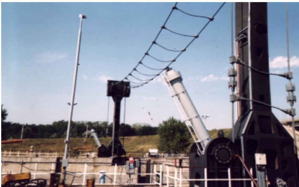
Fig. 5.22. Instalația hidraulică exterioară.
