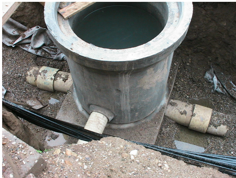
Figura 2. 16 Cămin de beton pentru canalizare
