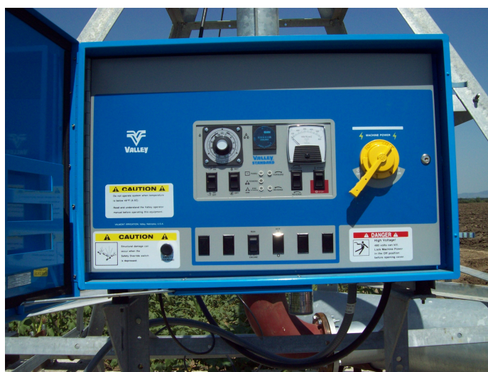
Figura 5.50 Panoul de comandă al instalației pivot central remorcabil Valley (foto Cîmpan G.)
