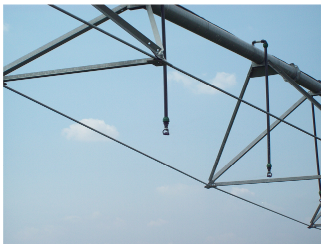
Figura 5.58 Conducta de udare suspendată prevăzută cu aspersoare (foto Cîmpan G.)
