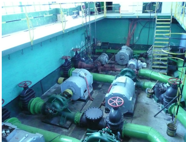
Figura 5.11 SPP Fântânele, vedere interioară cu agregatele de pompare NDS (foto Cîmpan G.)
