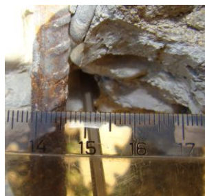
4) Glonț în beton
