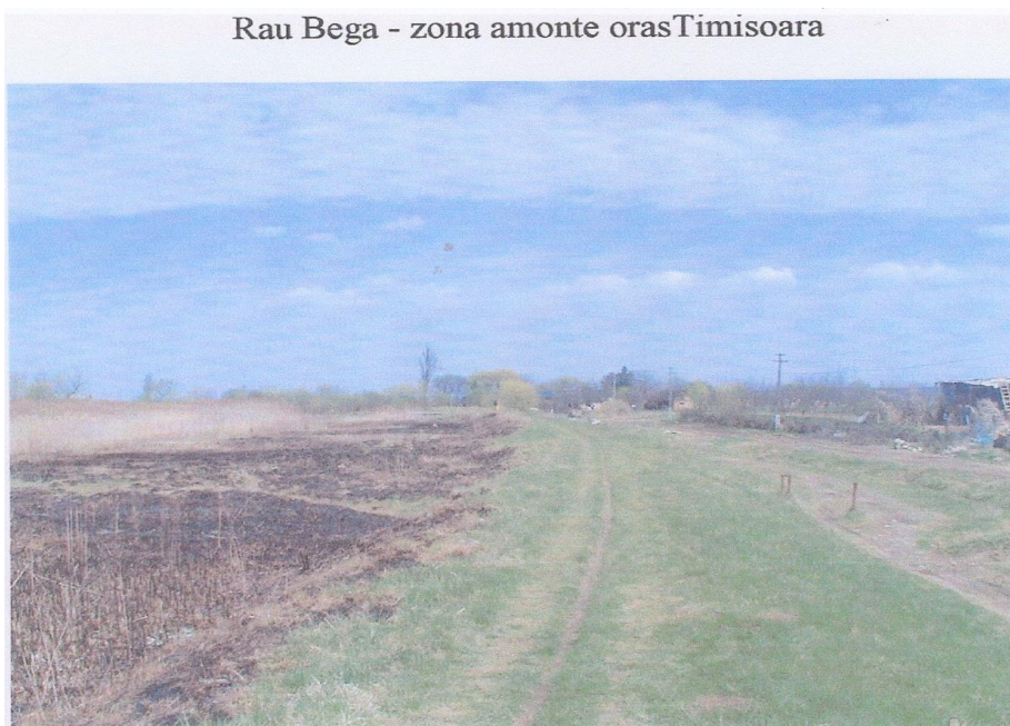
Fig. 4.81 – Dig erodat, vegetație
