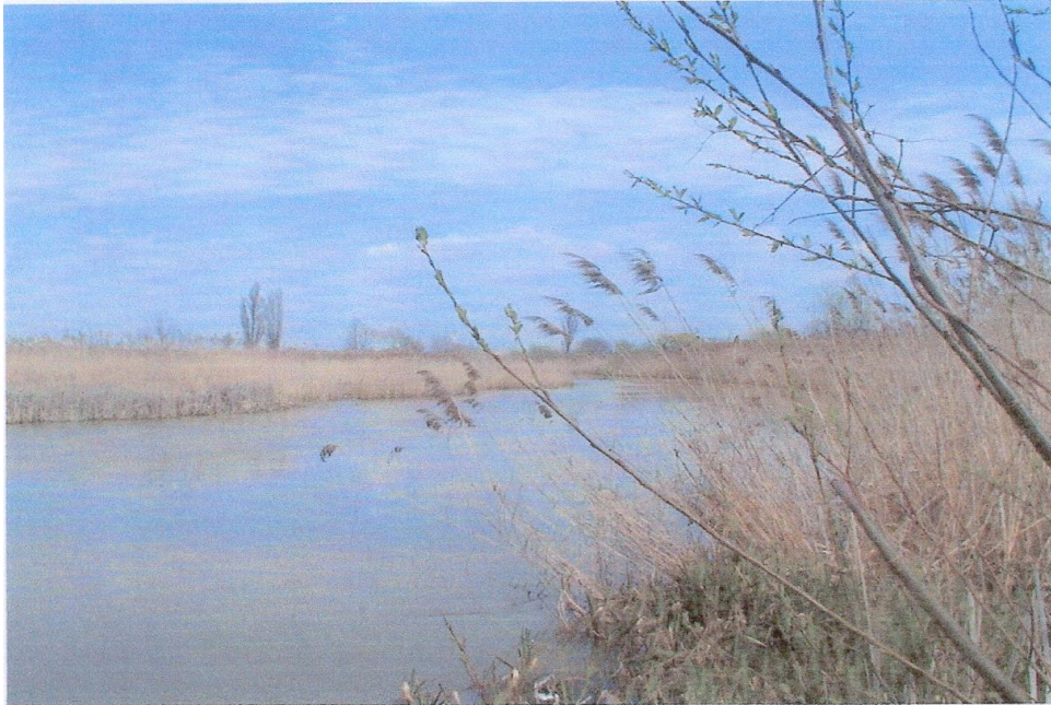
Fig. 4.87 – Eroziuni mal stâng, secțiune obturată de vegetație, depuneri mal drept
