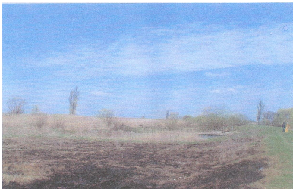
Fig. 4.82 – Dig erodat, vegetație
