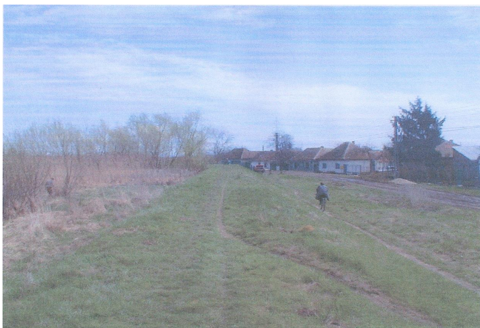
Fig. 4.86 – Dig cu taluz spre apă erodat, vegetație
