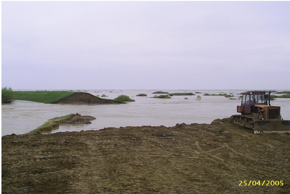
Fig. 4.50 – Ruptura în digul de la Crai Nou și vederea terenului inundat
