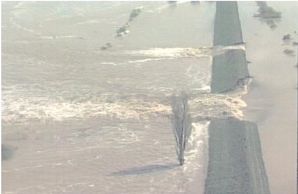
Fig. 4.46 – Ruptura de la km 6+500 pe râul Timiș la Crai Nou la viitura din aprilie 2005. Vedere din elicopter
