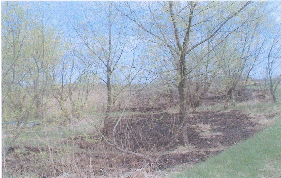
Fig. 4.83 – Dig erodat, vegetație arborescentă pe taluz, eroziune mal – pericol distrugere dig
