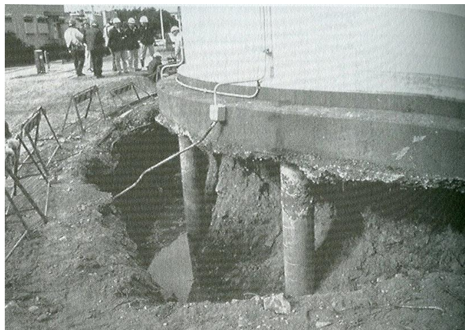
Fig. 6.5. Rezervorul avariât, datorită lichefierii pământului în timpul cutremurului din Kobe, 17 Ianuarie 1995.
