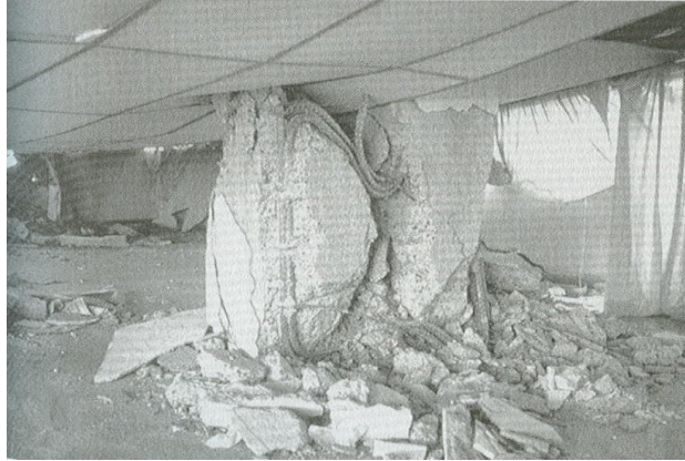
Fig. 2.25. Vedere de aproape a stâlpului care a cedat din cauza torsiuni
