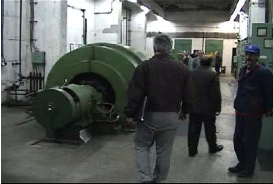
Figura 5.2. Vedere generală a celor 2 grupuri de la SP Lotru Aval
