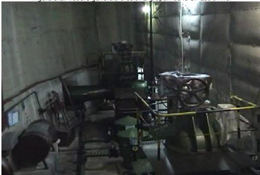
Figura 5.3. Vedere generală a celor două vane plane amplasate pe conductele de aducțiune amonte de la SP Lotru Aval
