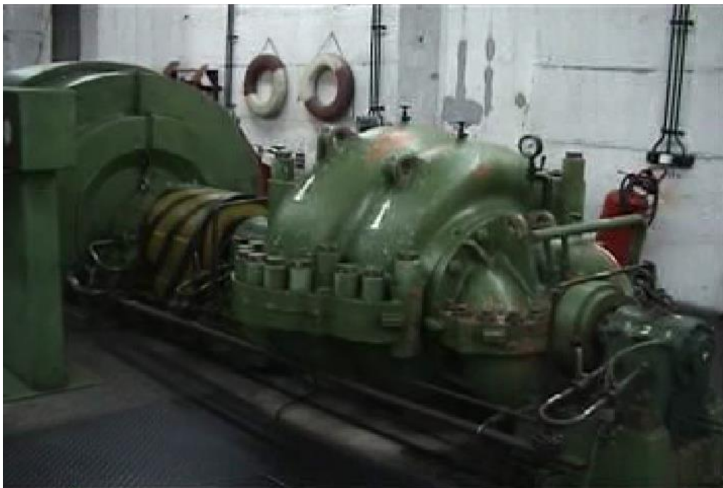
Figura 5.5. Vedere a grupului motor-pompă din SP Lotru Aval
